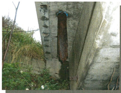
写真-6 排水管の腐食(福浦橋 15m以上)
