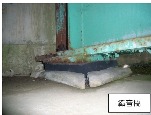
写真2 沓座モルタルの損傷
