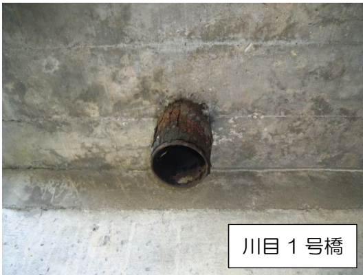
写真1 排水管の損傷
