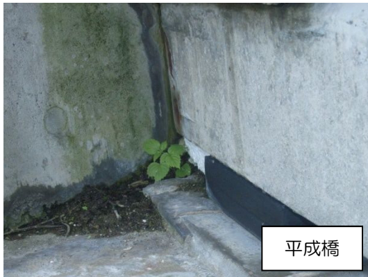
写真1 沓座モルタルの損傷
