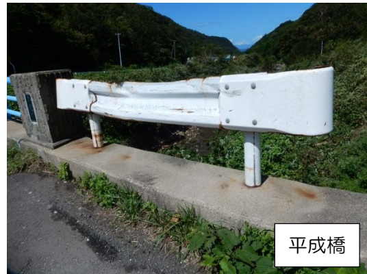
写真2 ガードレールの損傷
