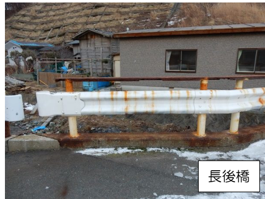
写真4 ガードレールの損傷
