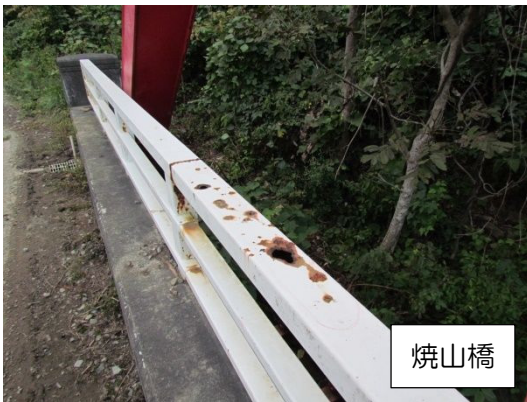
写真3 防護柵の損傷
