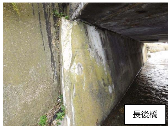
写真3 下部工の損傷
