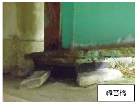
写真2 沓座モルタルの損傷
