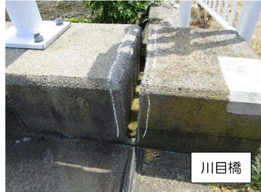
写真2 伸縮装置(地覆部)の損傷
