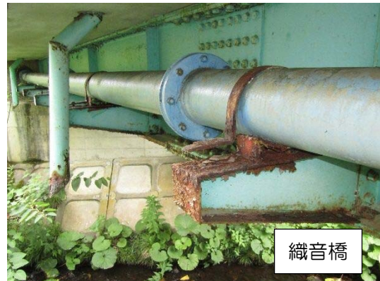
写真4 添架管の損傷
