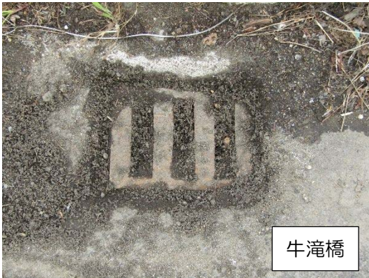
写真3 排水ますの損傷
