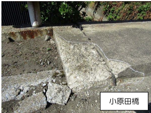
写真1 下部工の損傷
