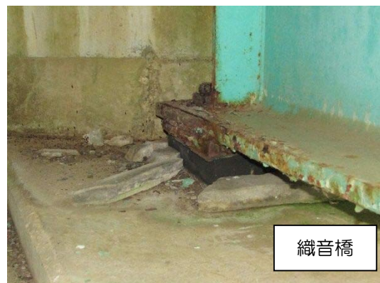
写真2 沓座モルタルの損傷
