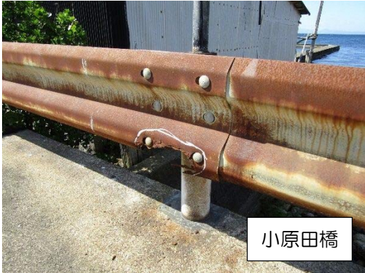
写真1 ガードレールの損傷
