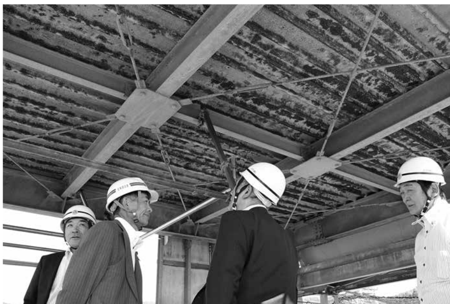
錆びによる腐食が激しい
