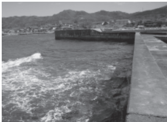
原田漁港には消波ブロックが設置されていない
