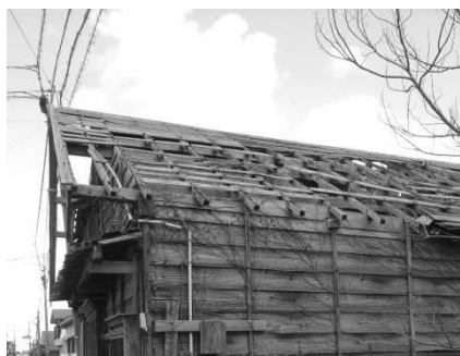
空き家となり、長年手入れがされず 屋根がない状態となった家屋
