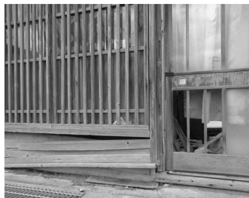
玄関部分が破損した空き家 動物の住みつきなどが懸念される
