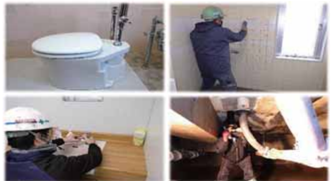
※佐井小学校・佐井中学校に設置したトイレ
